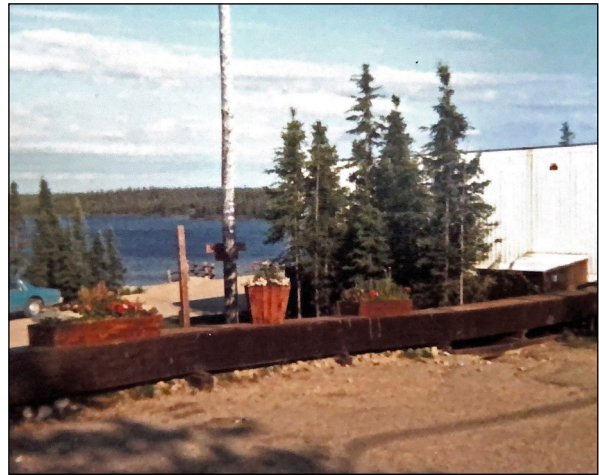
Le vue d'un « utilidor », corridor en bois, servant à protéger les tuyaux d'eau, les égouts et l'huile de chauffage
